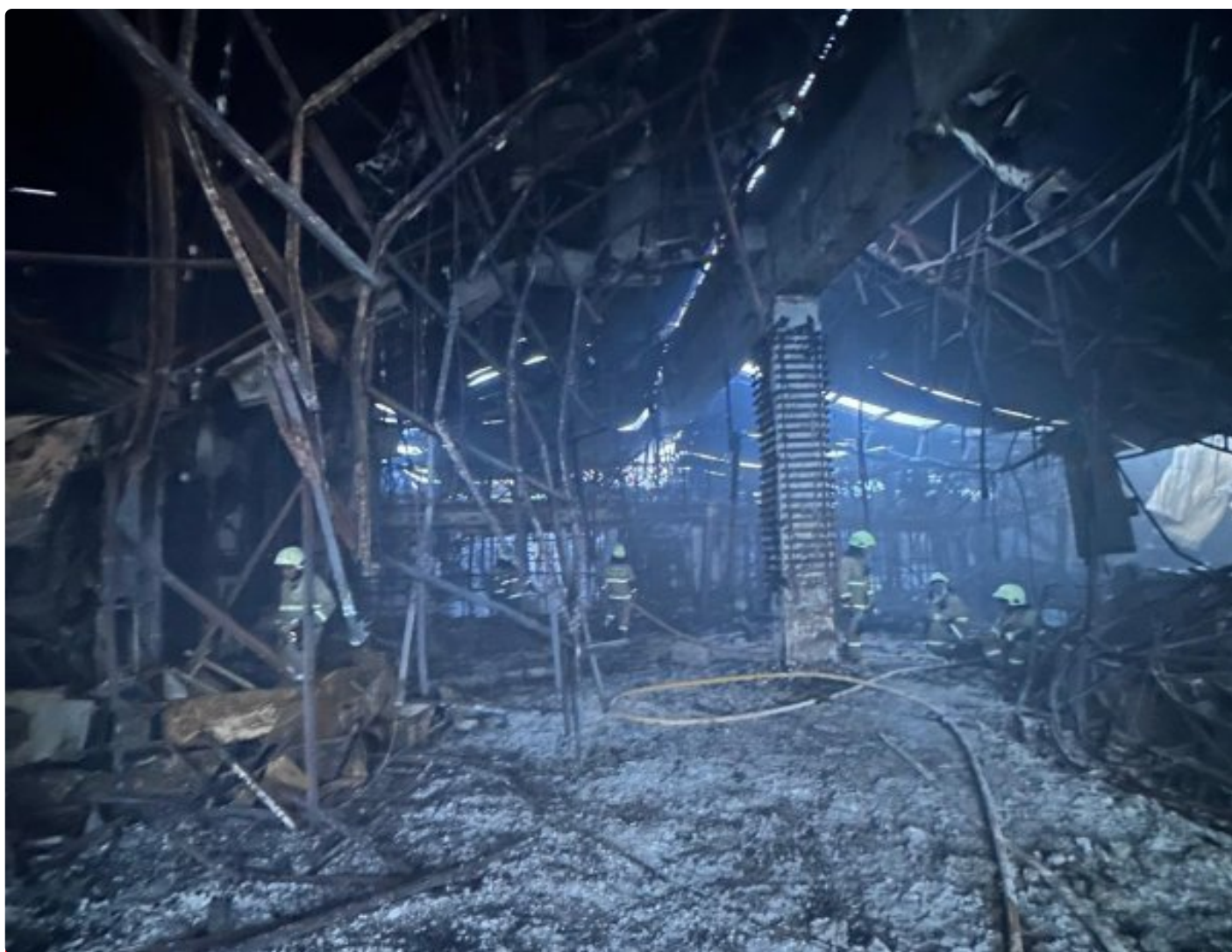
Glodok Plaza yang Hangus Terbakar
